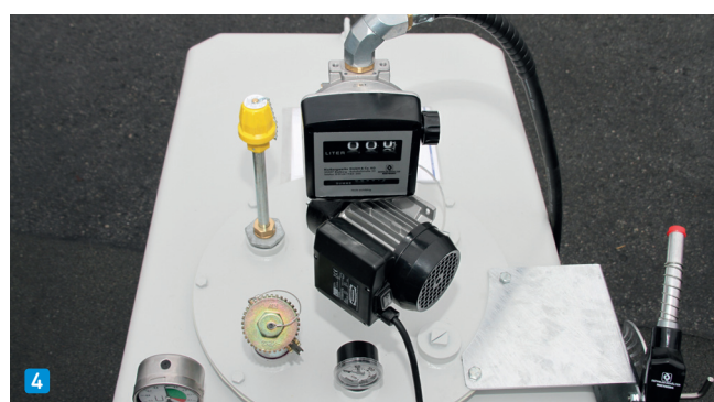
MT 2400 als Dieseltankanlage mit Pumpe R50 230, Zapfventilhalter, GWG und Zählwerk Typ PZ300
